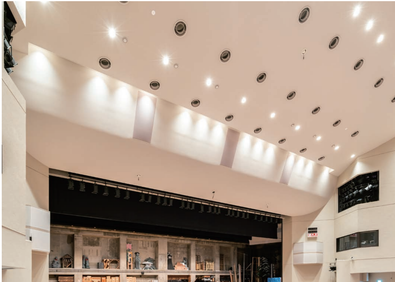
■ 支持構造部 ■ 当社下地材（準構造耐震天井：KIRII アングルクランプ）
