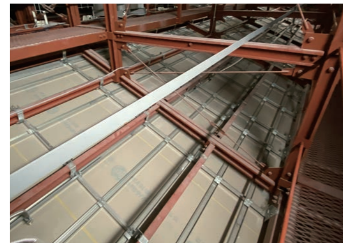
大ホール 天井裏の様子 (KIRII アングルクランプ)
