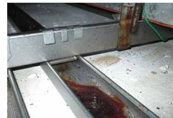
錆びた天井下地の例。劣化すると、強風や地震の揺れをきっかけに天井全体が崩落する恐れがある
