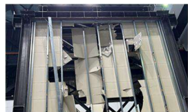
(b) ボードの脱落 写真1 損傷状況
