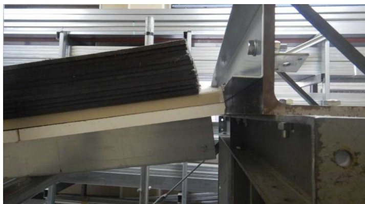
写真1 試験体1の上部脱落の状況
